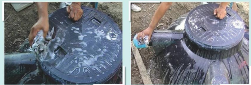
รูปที่ 2 การตรวจสอบรอยรั่วที่ปลั๊กอุด และฝาปิด
