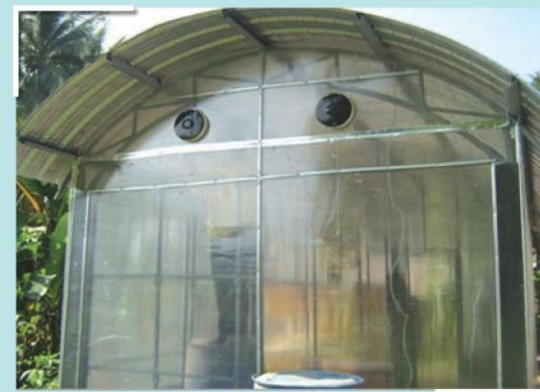
รูปที่ 13 การติดตั้งพัดลมดูดอากาศและสายไฟ พร้อมสวิตช์พัดลม
