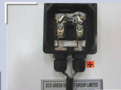
การเชื่อมต่อที่ไม่ถูกต้องในภาพ ทำให้จุดต่อ ไม่มีความแข็งแรงและยังมียางงว้าง ให้น้ำและความชื้นเข้าไปได้ง่าย
